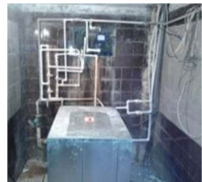
Обвязка теплового насоса
